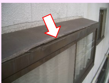
出窓の先端が破れている
