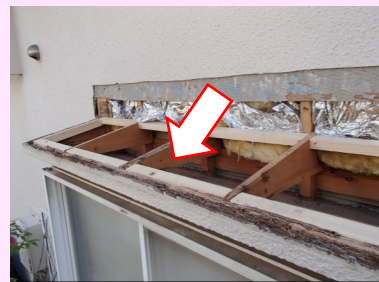
ヒサシの先端が腐っていた
